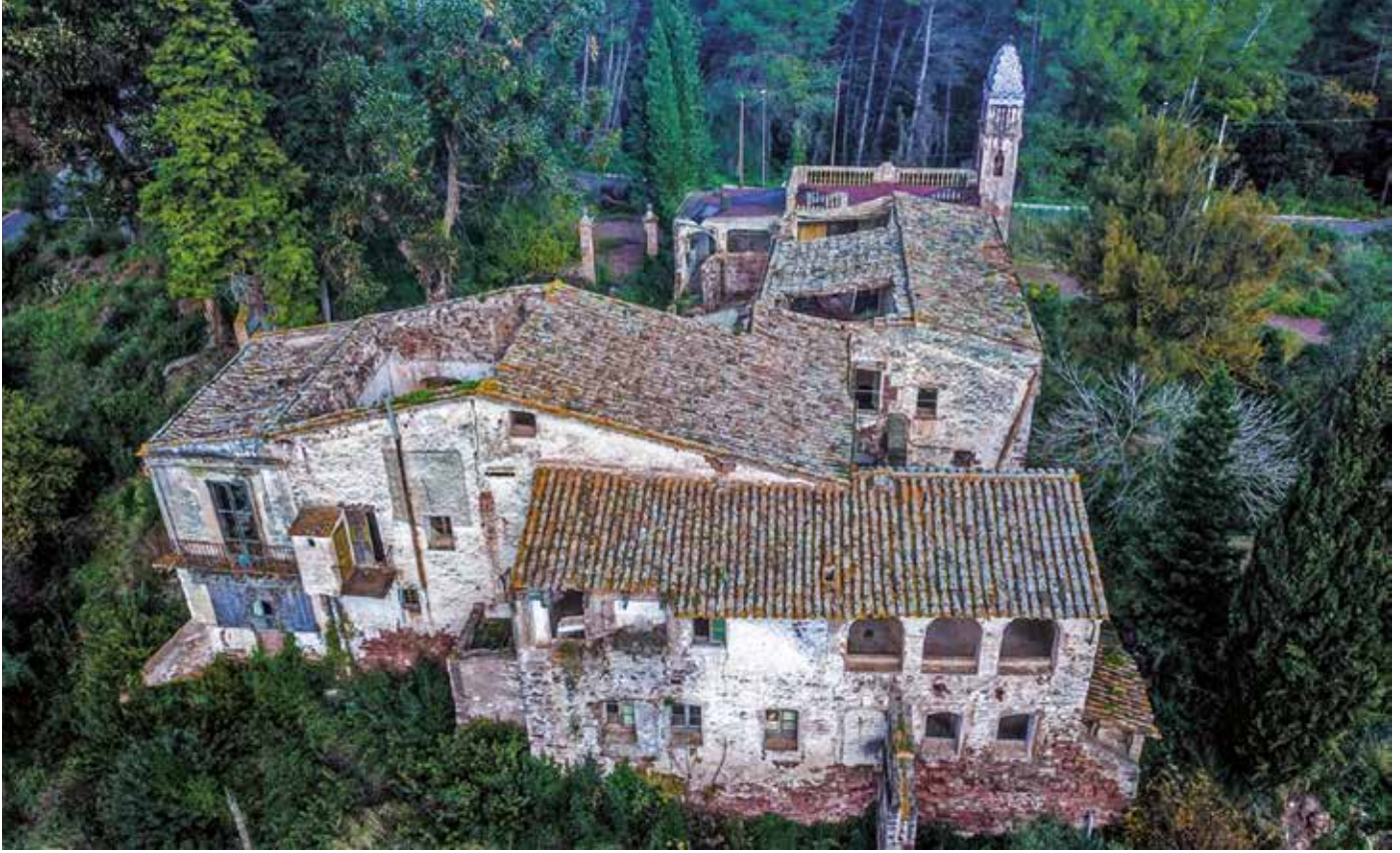
Vista aèria del Mas Pitarra on s'observa l'actual estat de ruïna en que es troba Foto: Fermín Fernández
