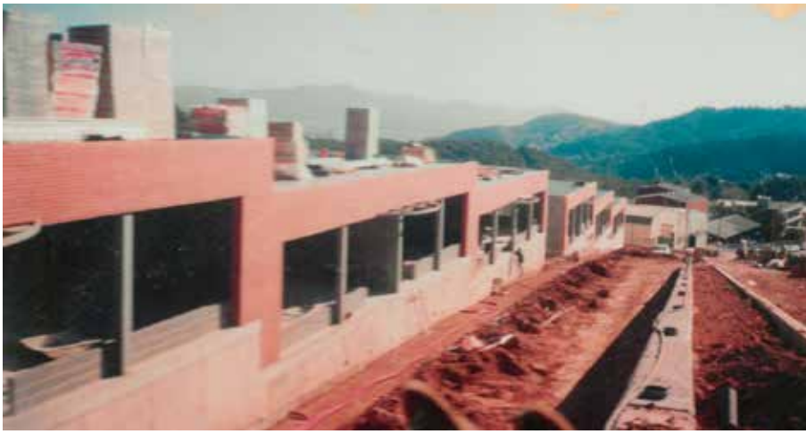
Construcció de les naus del carrer Joan Torruella i Urpina. 1 de març de 2000
